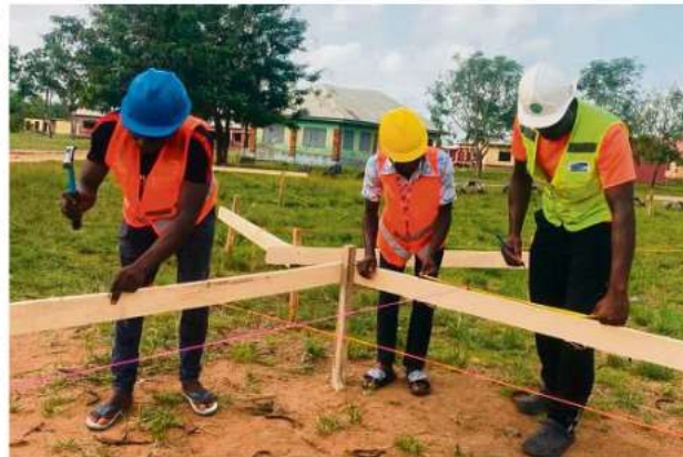
Endlich geht es los: Der Bau des Jugendzentrums im ghanaischen Mafi Dadoboe ist in vollem Gange. Foto: Privat
